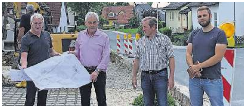
Martin Kölbl, Bürgermeister Eduard Meier, Reinhold Knör und Tobias Tannenberger besichtigten die Baustelle.
